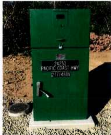
Waste Water Treatment Box (d)
